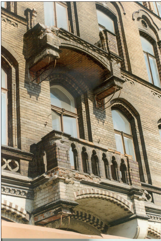
16. Uszkodzone balkony z odsłoniętą konstrukcją w kamienicy przy ul. Marszałkowskiej 72. Fot. J. Roguska, 1999 16. Damaged balconies with exposed construction in the tenement house at 72 Marszałkowska St. Photo: J. Roguska, 1999
