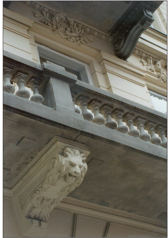
21. Wsporniki balkonów 1. i 2. piętra w kamienicy przy ul. Nowogrodzkiej 44. Fot. J. Roguska, 2004 21. Truss of the balconies on first and second floors in the tenement house at 44 Nowogrodzka. Photo: J. Roguska, 2004
