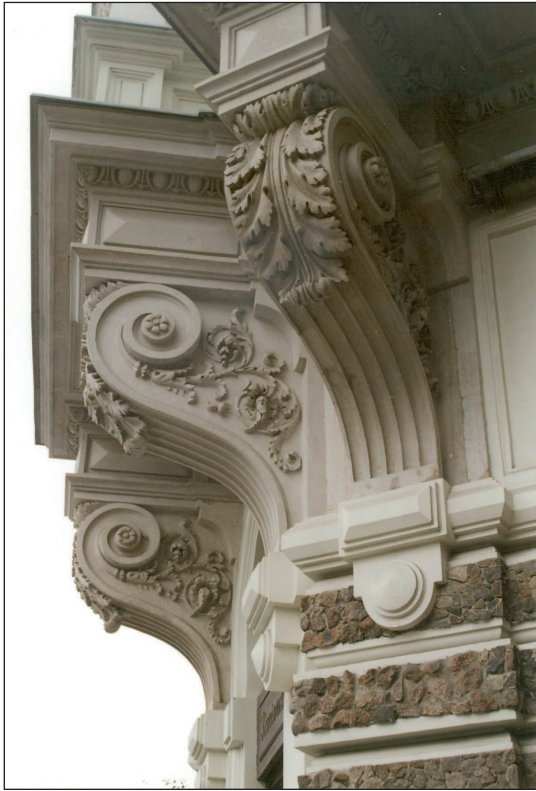
20. Wsporniki wykusza i balkonu w kamienicy przy zbiegu ulic Zgoda i Górskiego. Fot. J. Roguska, 1999 20. Truss of the bay window and balcony in the tenement house at the crossroads of Zgoda and Górskiego Streets. Photo: J. Roguska, 1999
